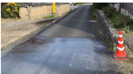
道路から水がわき出て路面が濡れている状態
