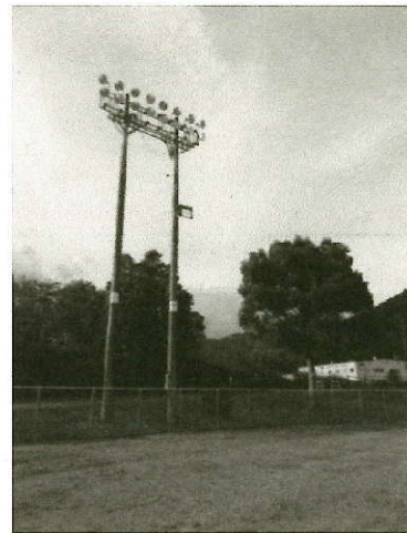
(氷上総合グラウンド 野球場夜間照明設備)
