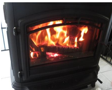
青垣住民センター薪ストーブ
