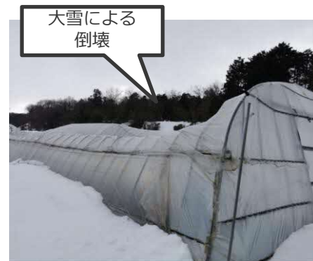
農業用ハウスの補強対策未実施
