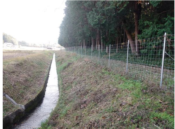
山際に設置された防護柵
