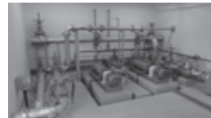
施設内部 送水ポンプ
