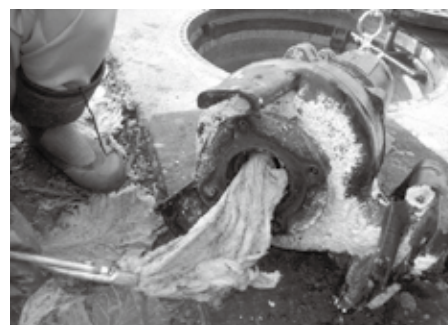
異物による詰まり(タオル)
