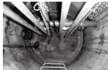
マンホール内に油のかたまりが堆積している状態
