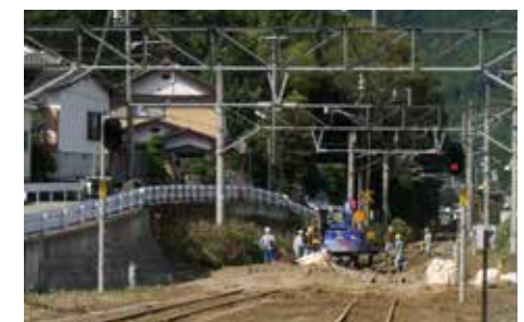
線路に土砂が流れ込み、一時不通となったJR市島駅
