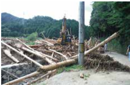
流木が堆積し、危険な状態の河川（市島町上鴨阪）
