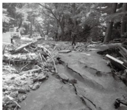
氷上町香良の被災現場
