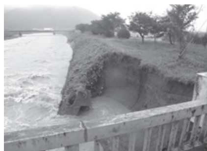
橋のそばの川面が崩落した青垣大橋下流右岸(青垣町西戸田)
