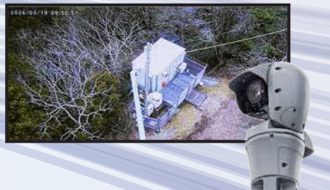
高所監視カメラ装置
