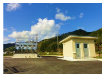
乙河内加圧ポンプ場 (H28 年度建設)
