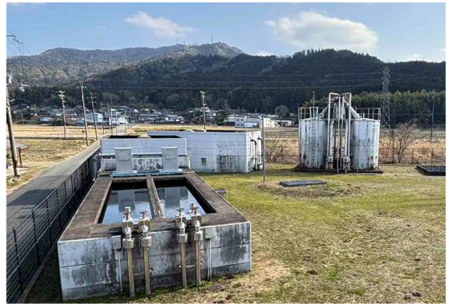
設備全体の老朽化が進んでいる。
