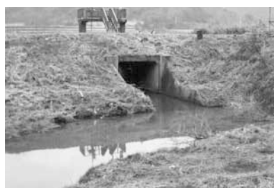
△排水対策がされていない指定河川
