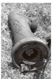
老朽化する消火栓
