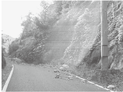
△1年近く崩落のままの生活道路
