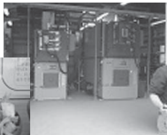
△チップボイラー
