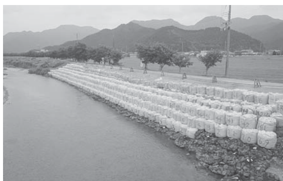
△一部崩壊した加古川堤防
