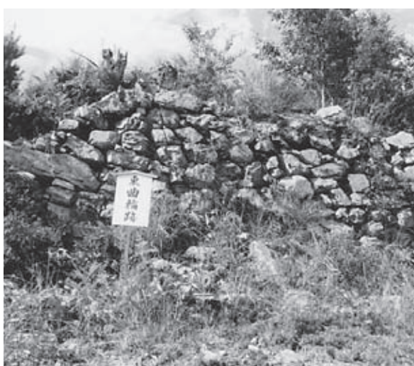
△崩落の激しい石垣（山頂）
