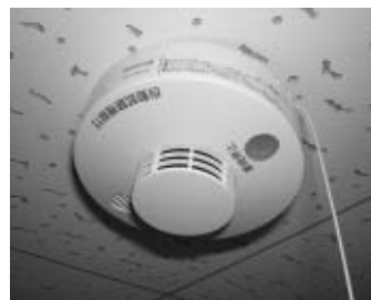
△義務づけられる住宅用防災警報器
