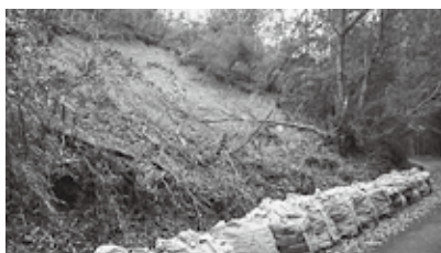
山肌が崩壊し、土砂の流失を防ぐため土のうが設置された現場。
