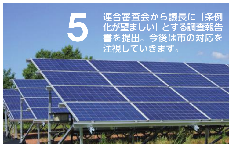
大型の設備が住居に接近する事例も。
