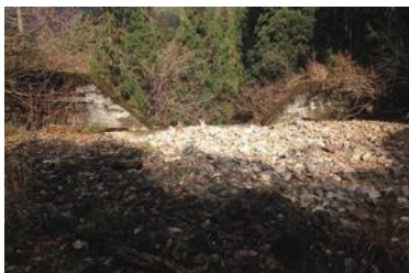
機能を失っている堰堤
