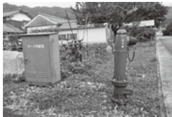
消火栓と格納庫
