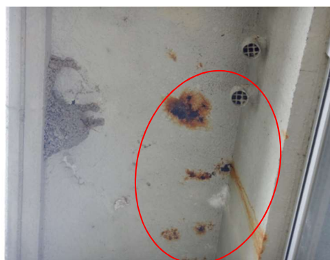
C 評価：外壁の腐食
