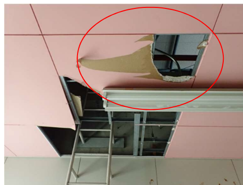
C 評価：天井材の落下
