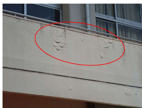
B 評価：外壁塗装の浮き
