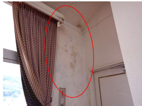
C 評価：内壁の漏水跡
