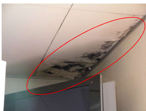
C 評価：天井の漏水跡
