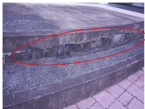
C 評価：屋外階段ひび割れ
