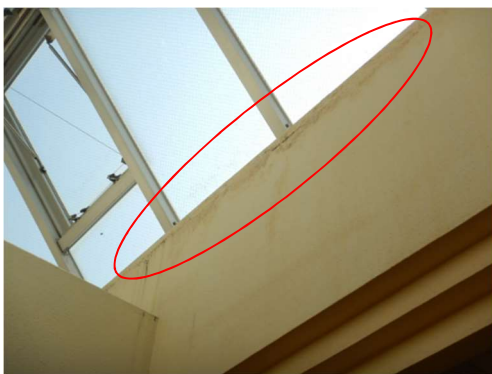
B 評価：窓の漏水跡
