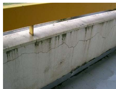
D 評価：広範囲のひび割れ (春日中学校校舎)
