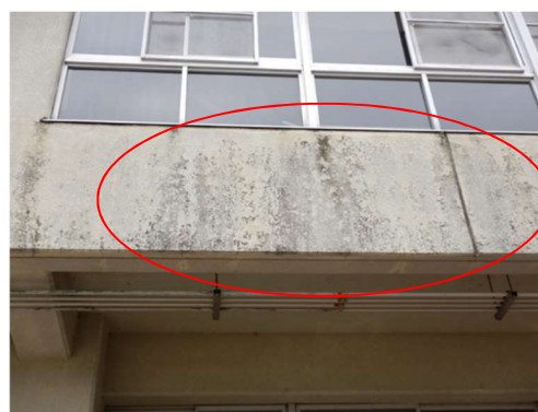
C 評価：外壁塗装の剥がれ
