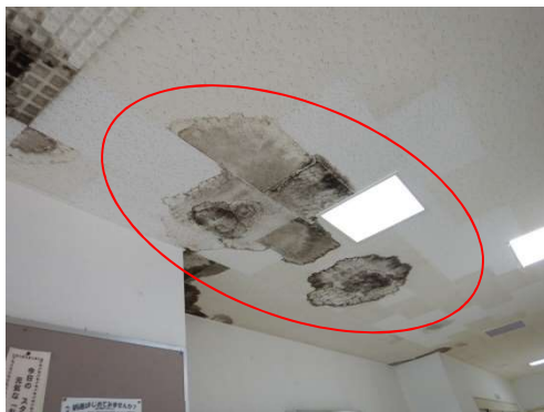
D 評価：廊下天井の漏水跡
