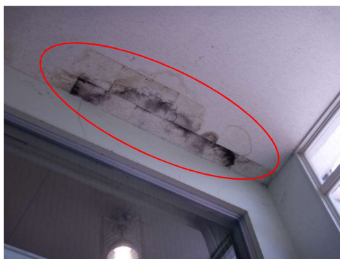
C 評価：天井の漏水跡
