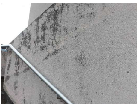
D 評価：ひび割れ、腐食 (三輪小学校校舎)
