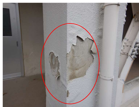
B 評価：外壁塗装の剥がれ
