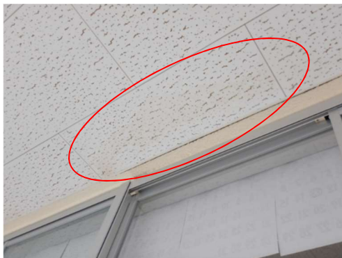
C 評価：天井の漏水跡
