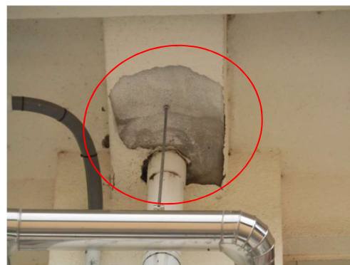
B 評価：軒裏塗装の剥がれ
