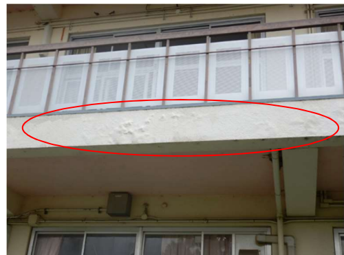
B 評価：外壁塗装の浮き
