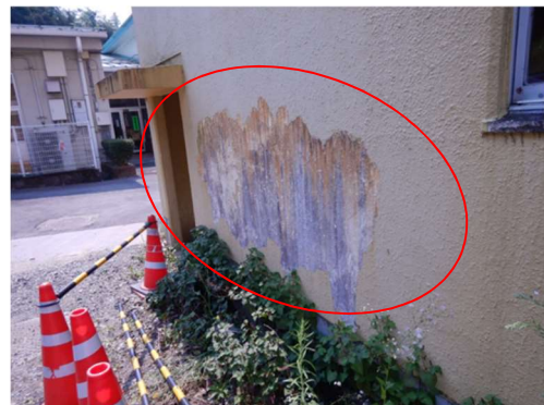
C 評価：外壁塗装の剥がれ
