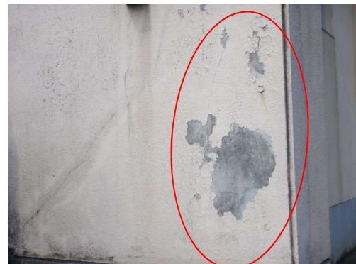
C 評価：外壁塗装の剥がれ
