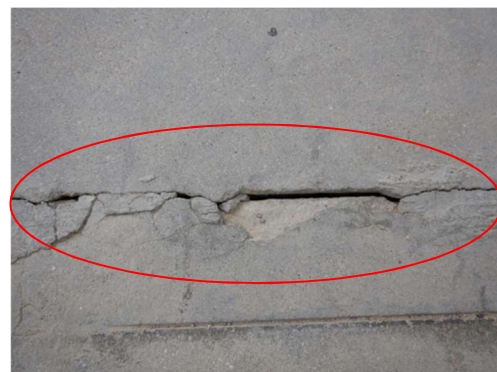
C 評価：外壁コンクリート剥離
