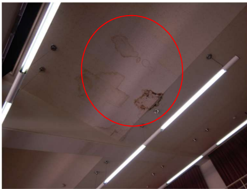
D 評価：天井の漏水跡
