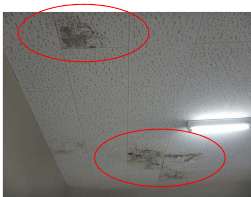
C 評価：天井の漏水跡
