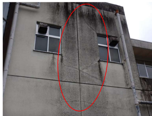
C 評価：外壁のひび割れ
