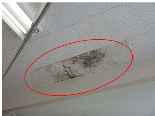
C 評価：天井の漏水跡
