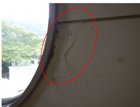
C 評価：内壁の漏水跡
