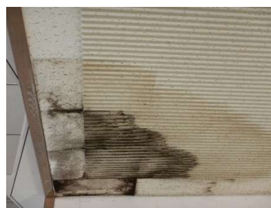
D 評価：漏水 (東小学校体育館)
