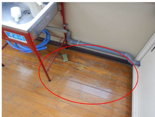
C 評価：床材の腐朽
