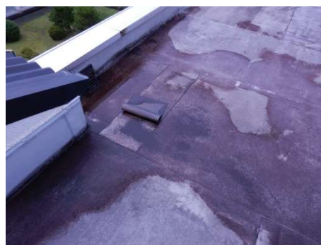
D 評価：広範囲の剥がれ (春日中学校校舎)
