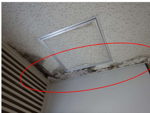
C 評価：天井の漏水跡
