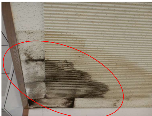
D 評価：天井の漏水跡
