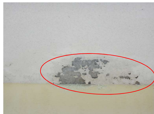
C 評価：軒裏塗装の剥がれ
